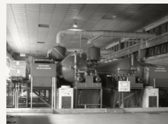
Station de préservation autoclave - Site de production de Moullet (14)
